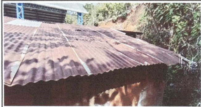
Foto 2: lamina doblada en la esquina del aula del lado norte, donde se filtra el agua.
