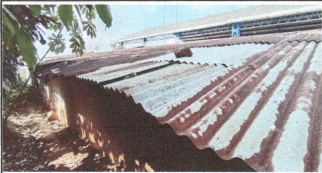
Foto 1: laminas deterioradas en la parte de atrás de las aulas.
