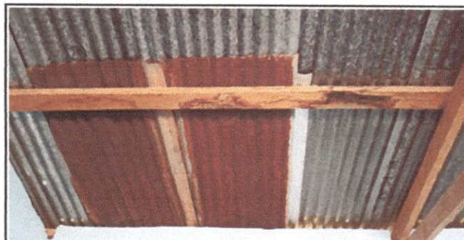
Foto 6: lamina sobre puesta por mal estado.
