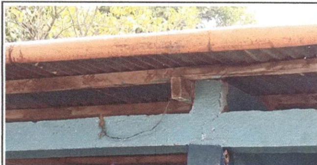
Foto 5: canales en mal estado con agujeros donde se filtra el agua a las aulas corredor y cancha polideportiva.
