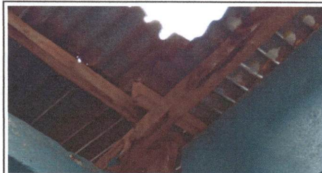
Foto 4: tendales en descomposición y con riesgo de quebrarse.
